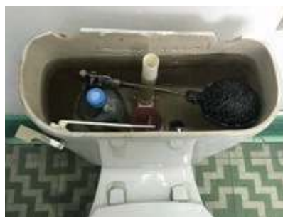
Figura 2.93 La botella puede colocarse de manera vertical u horizontal dentro del inodoro, lo importante para el ahorro de agua, es que se mantenga sumergida.
