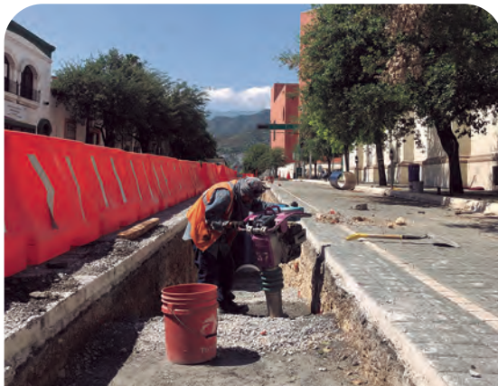
Drenaje en Monterrey.
