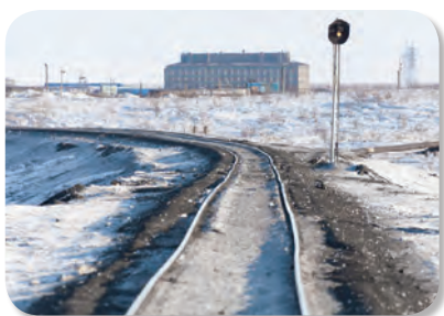
Figura 1.13 La dilatación térmica puede deformar las vías del ferrocarril y ocasionar accidentes.
