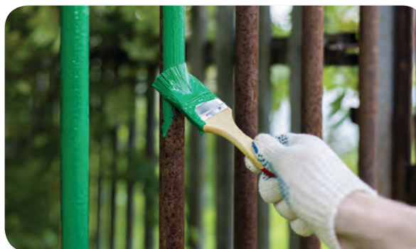
Figura 1.42 Para evitar el deterioro del hierro en estructuras de uso cotidiano, es necesario recubrirlo con materiales resistentes a la corrosión, como la pintura y el barniz.
