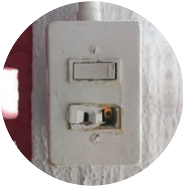
Figura 2.68 Todo desperfecto eléctrico debe de ser reparado rápidamente para evitar accidentes.
