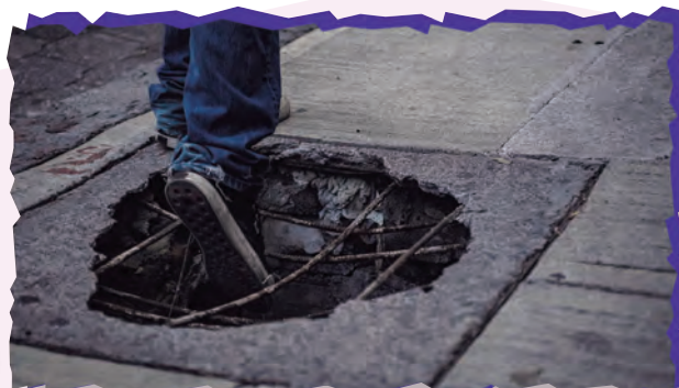
➤ Falta de mantenimiento de una coladera
