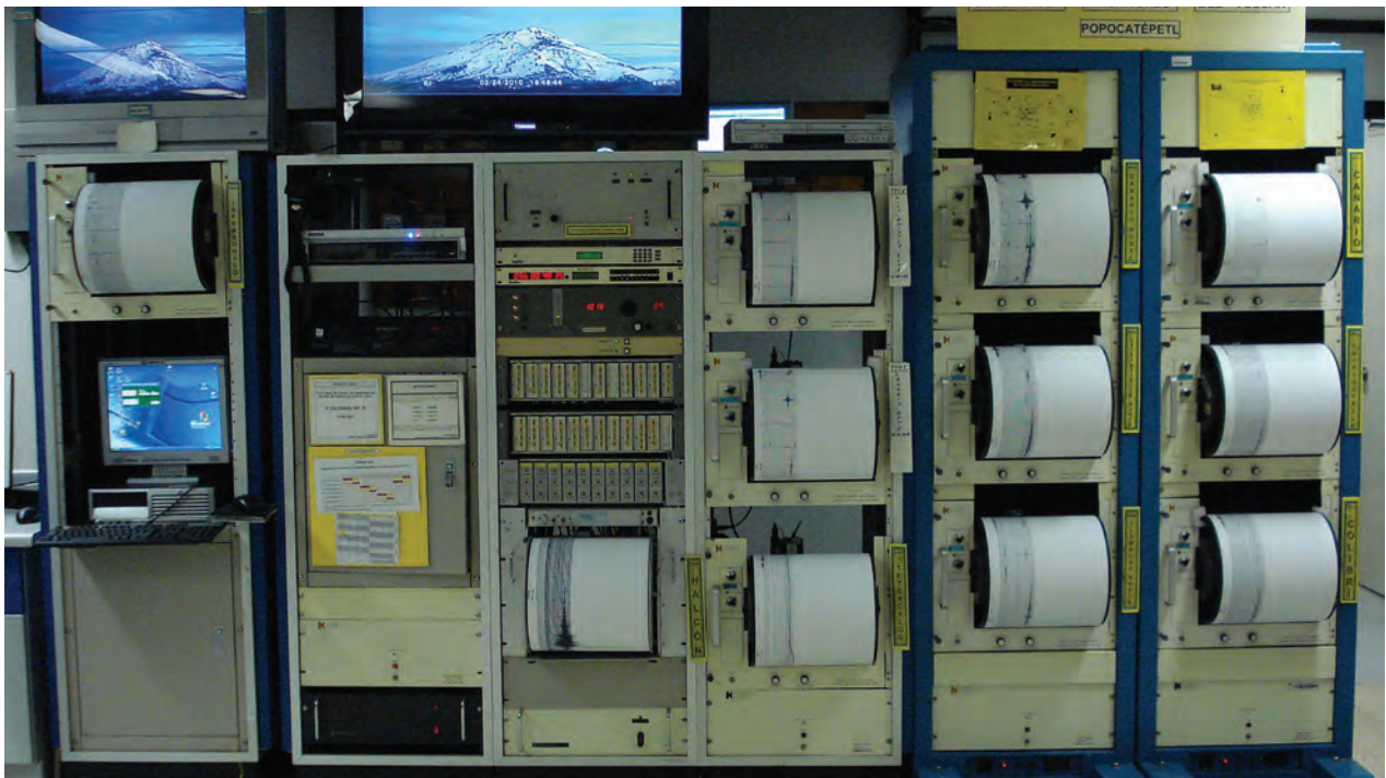
Centro Nacional de Prevención de Desastres (Cenapred). Laboratorio de instrumentación sísmica y monitoreo volcánico.
