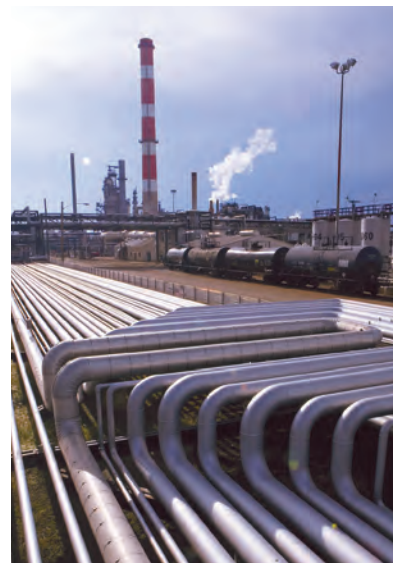
◆ Refinería en Canadá.
