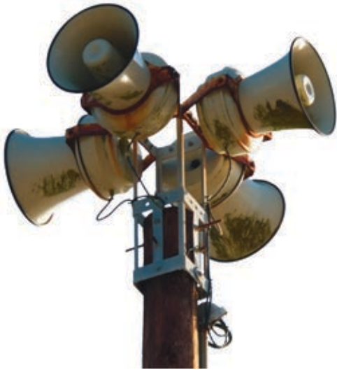
Sirena de tornado.
