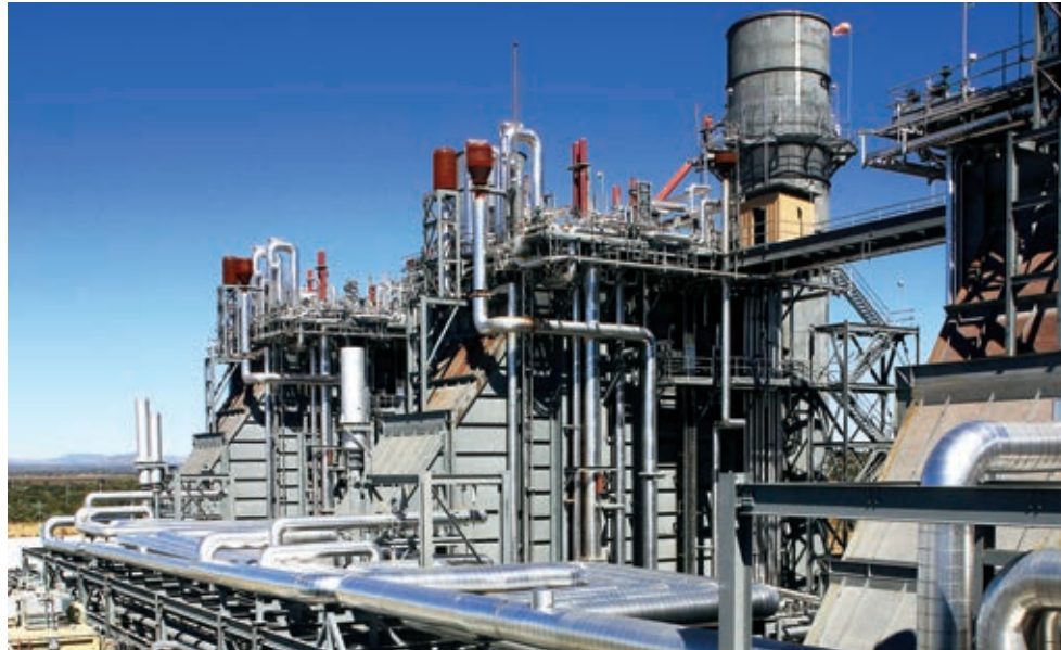
Central eléctrica, México.
