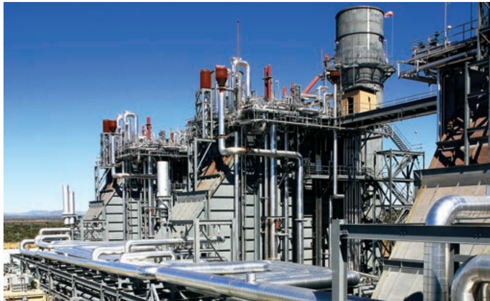
Central eléctrica, México.
