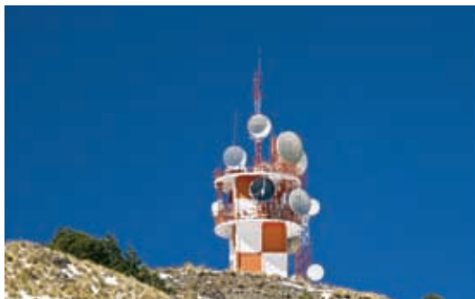
Estación de comunicaciones Arsononi, en el Paso de Cortés.
