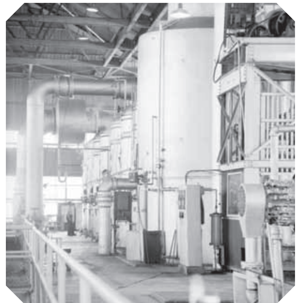
▲ Instalación industrial en el ingenio Xicoténcatl.
