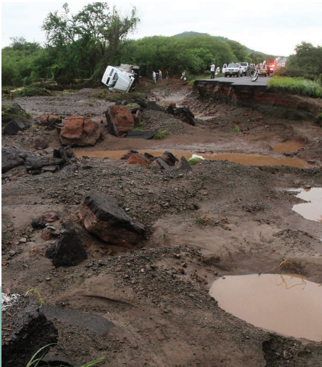
Daños por lluvias cerca de Mazatlán.
